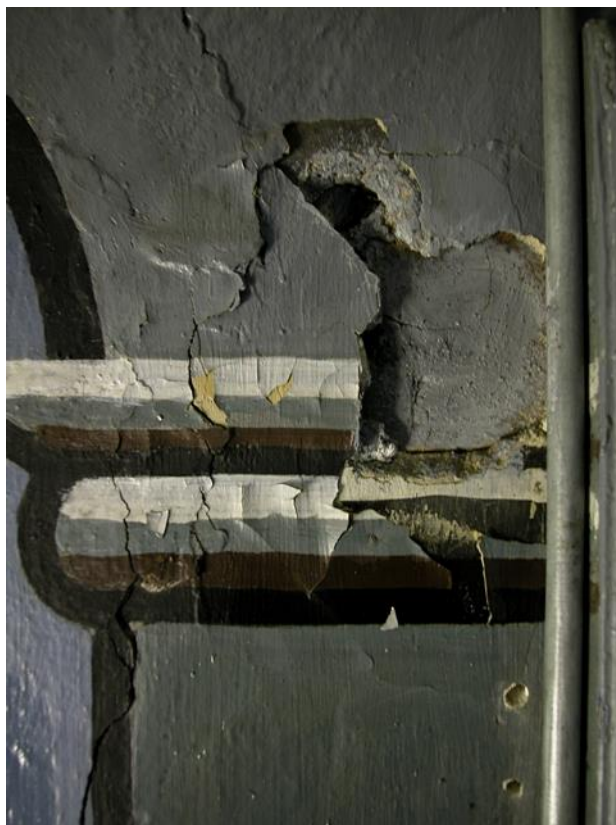
Bild. Skador i putsen på östra sidan om rummets dörr. (2383)
