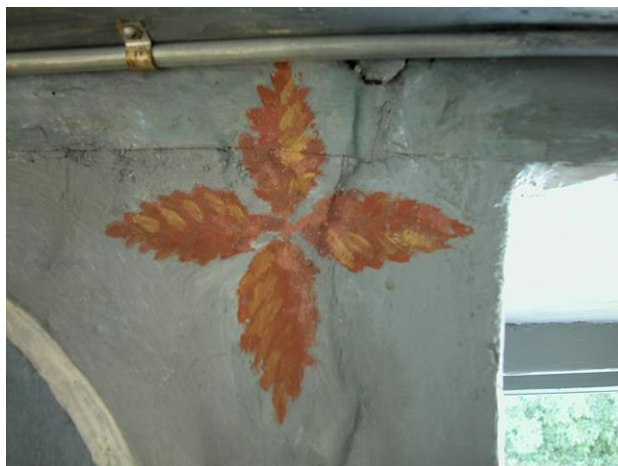
Bild. Skadorna i muren har lagats med bruk och retuscherats samt den lösa pappersremsan har fästs med lim. (2621)
