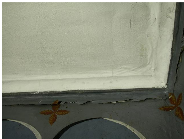
Bild. Vid salens sydöstra hörn hade en stor del av pappret vid taklisten lossnat från underlaget. (2283)
