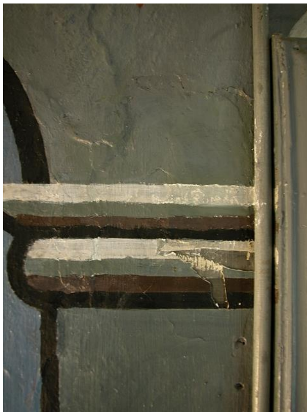
Bild. Där putsen saknades fylldes hålet med kalkbruk. Skador i färgen som på föregående bild ses som ett sprickmönster med stora konkava flagor limmades fast med syntetiskt lim och flagorna jämnades till med värmespatel. (2580)
