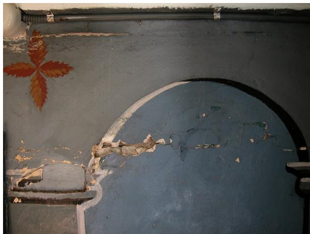
Bild. Sprickor och andra skador i muren väster om rummets dörr. (2386)
