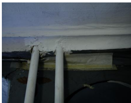
Bild. Skador bakom värmerören på rummets norra vägg. (2390)
