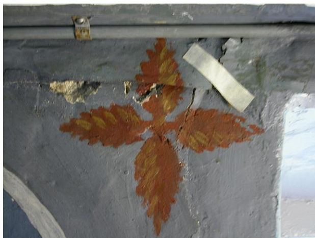
Bild. På nordväggen, mellan de två fönstren, hade putsen alldeles under taklisten skadats. Det hade bildats några sprickor och i anslutning till dessa hade bitar av putsen lossnat och fallit ned. Sprickan hade gjort en reva i pappret som lagats med frystejp. (2361)
