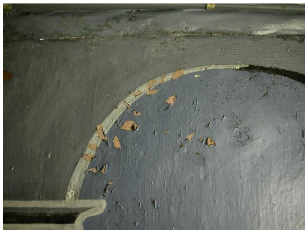
Bild. Färgskiktet på himlen ovanför Rosendals slott spjälkade från underlaget. Där färgen flagat av hade ett äldre måleri med rosa bottenkulör blivit synlig. (2326)
