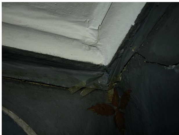
Bild. Skarven mellan taklist och vägg har innan väggmålningarna gjordes täckts med pappersremsor. Vid salens nordöstra hörn hade man försökt att tejpa fast en bit av pappersremsan som lossnat. (2391)
