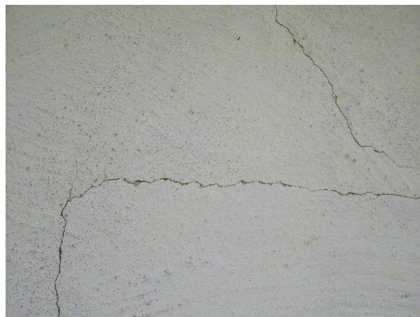
Sprickor i fasadens puts
