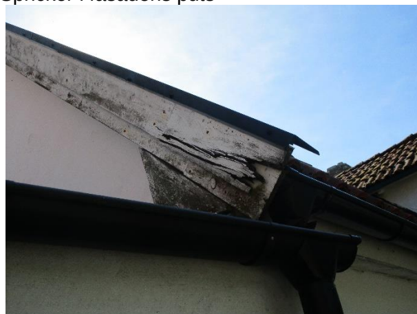
Rötskador på vindskiva
