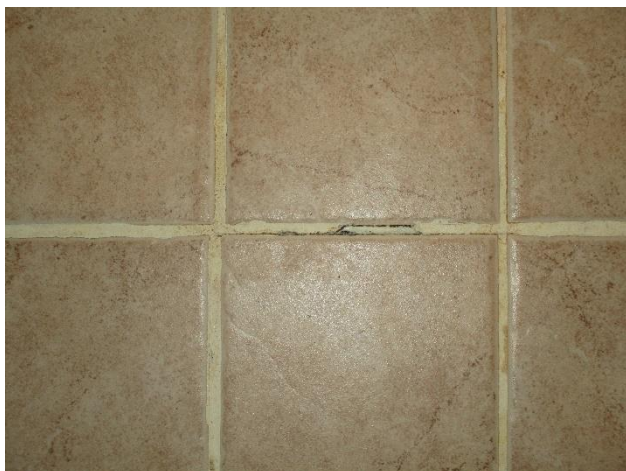
Klinkerfogar bristfälliga vid dusch
