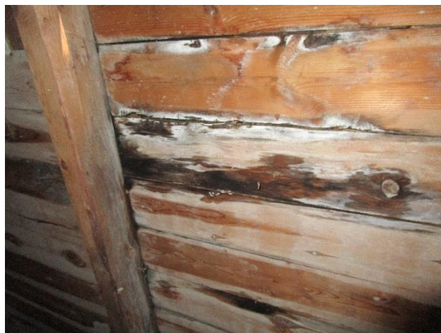
Fukt och rötskador samt vitmögel längs yttertakets insida på vinkelbyggnad mot norr
