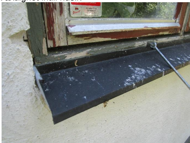
Fönster i behov av underhåll
