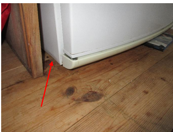
Läckageskydd saknas under kyl/frys i kök.
