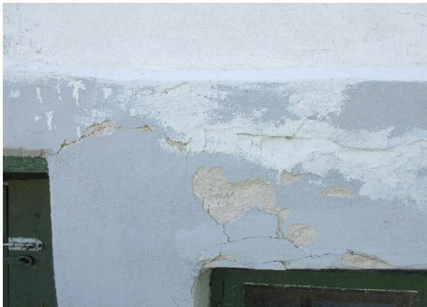
Sprickor i husets sockel.
