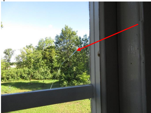
Trasig glastruta i vardagsrum.
