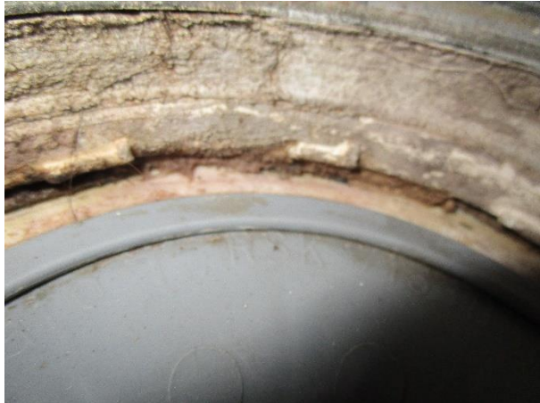
Fog och fix täcker anslutningen till klämringen
