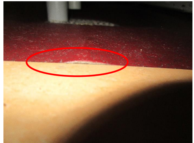
Golvbeklädnaden i tvättstugan är bristfällig
