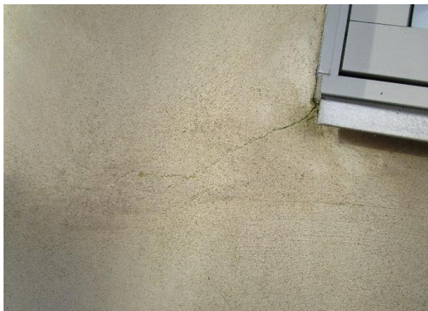
Krypnings sprickor i puts
