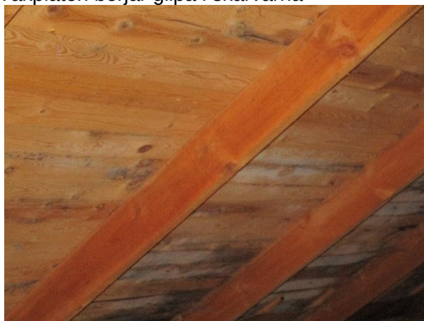
Spår av mikrobielltillväxt på råsponten
