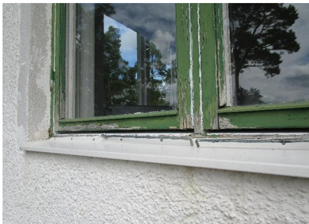
Vissa fönster har ett eftersatt underhåll
