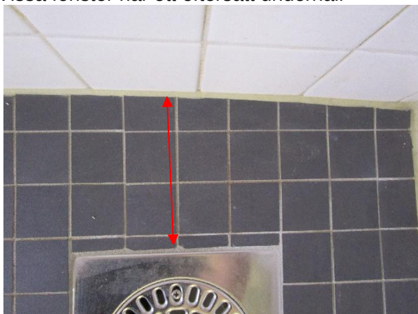
Golvbrunnen ligger för nära vägg
