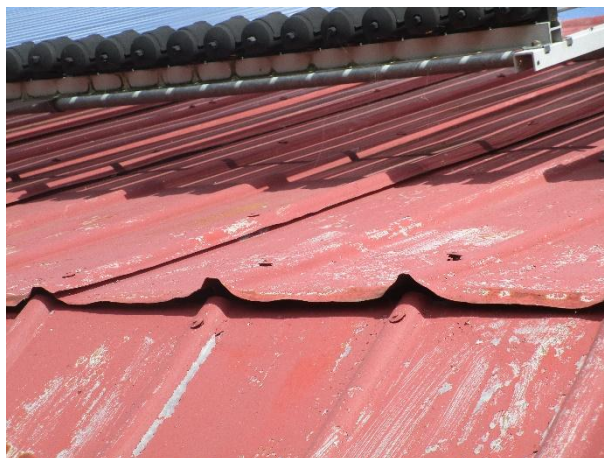
Takplåten börjar glipa i skarvarna
