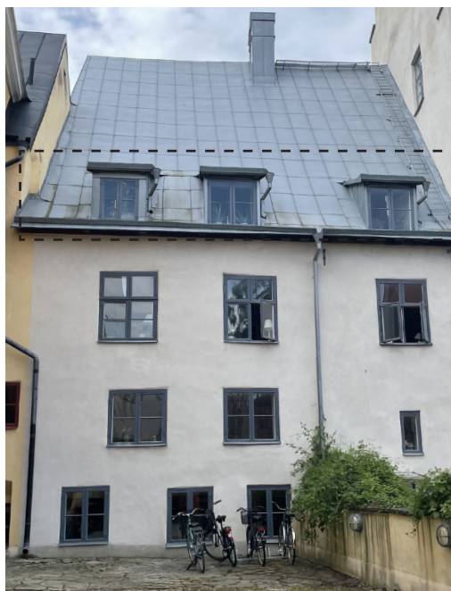
Norra takfallet med algpåväxt
