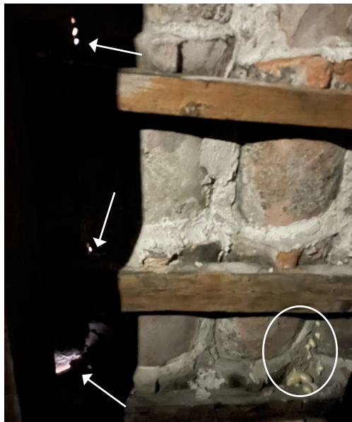
Håligheter och fogskum på det understrukna tegeltaket
