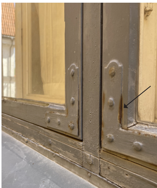
Rostangrepp på beslagen på fönsterbågar
