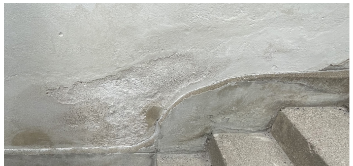
Skador i putsen på södra fasaden
