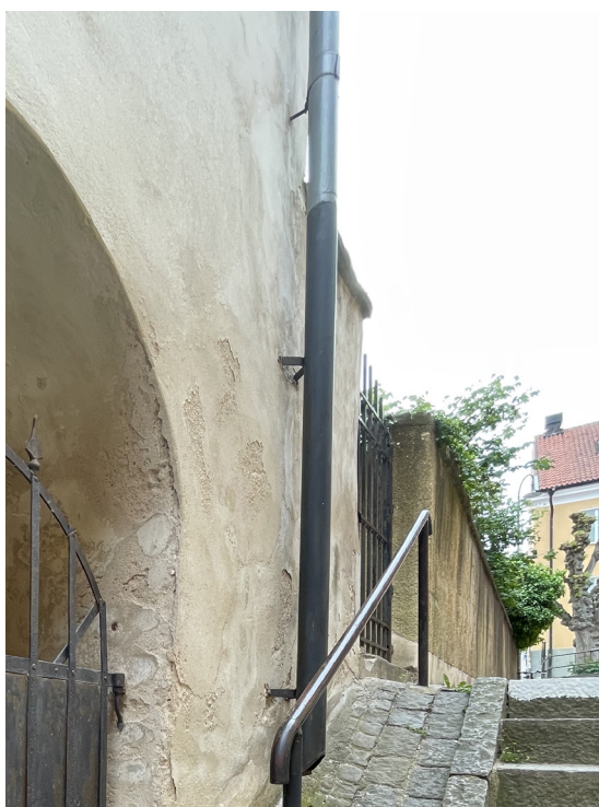
Stuprör och vandalrör på södra fasaden
